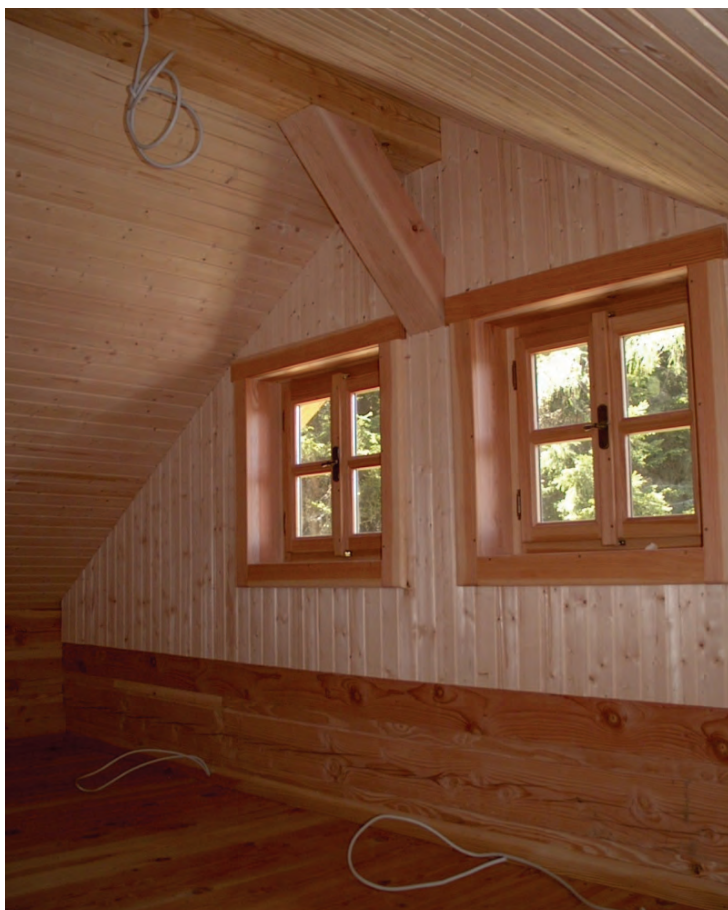
Interiér – srovnání dřevin – palubkový obklad - smrk, ostatní douglaska, povrchová úprava – Iněná fermež.
